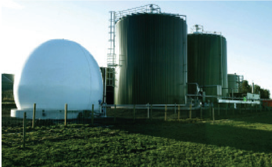
وحدة هضم لاهوائي للنفايات
